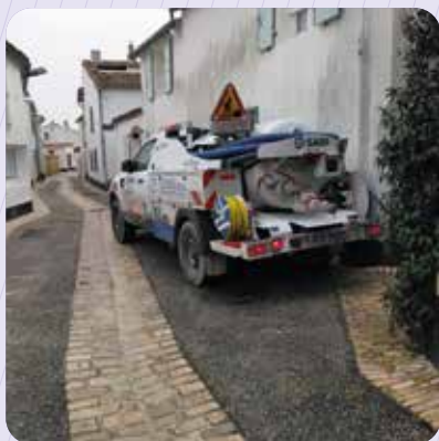
Ruelle Jean Dron, un curage a été réalisé en mars suite aux inondations récurrentes.
